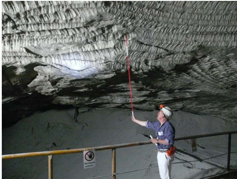
Abb. 5: Ablösungen an der Decke (Firste) der Kammer 7 auf der 725-m-Sohle.
