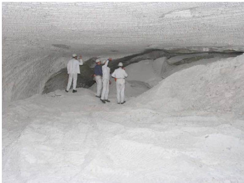
Abb. 6: Zustand der Kammer 7 auf der 725-m-Sohle nach den Sicherungsmaßnahmen.
