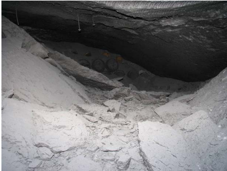
Abb. 7: Zustand der Kammer 5 auf der 750-m-Sohle vor den Sicherungsmaßnahmen.
