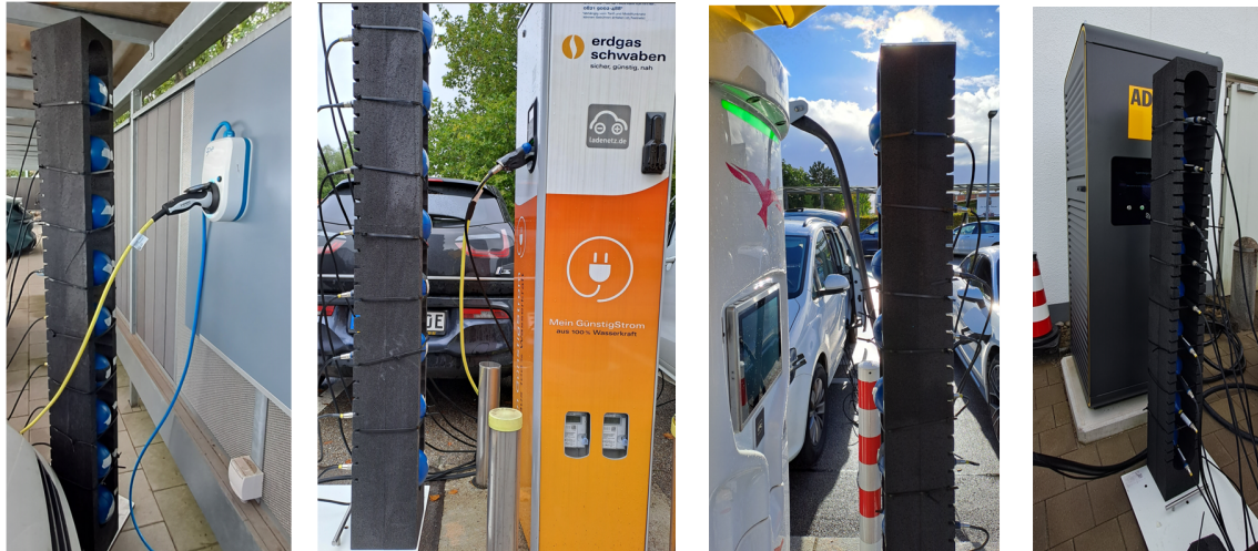
Abbildung 8.3: Anordnung der Messaufnehmer bei den Messungen in 30 cm Distanz zur Front der Ladesäulen.
