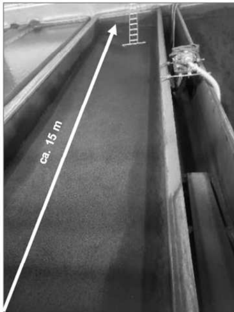
Abbildung 5-16: Festes Bauwerk (Becken) mit Filtersanden in einem Wasserwerk
