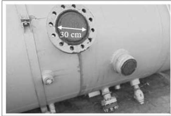
Abbildung 5-23: Tank mit NORM-kontaminierten Ablagerungen an den Innenwänden
